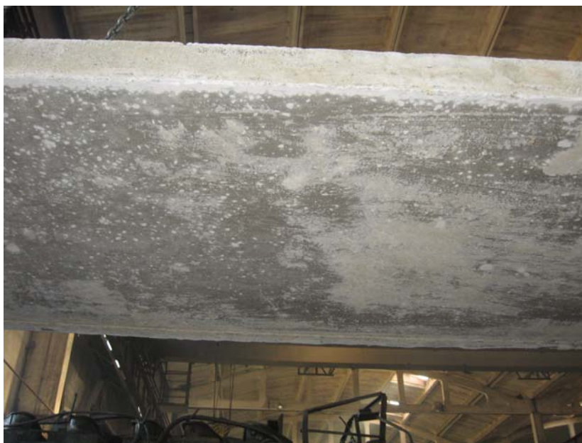
Рисунок 5 – Образец поверхности бетонной плиты после применения в качестве смазки для разборной опалубки эмульсии на основе масла ВД-3, жирной кислоты и неолола. Концентрат эмульсола подвергнут ультразвуковой обработке по разработанной методике
